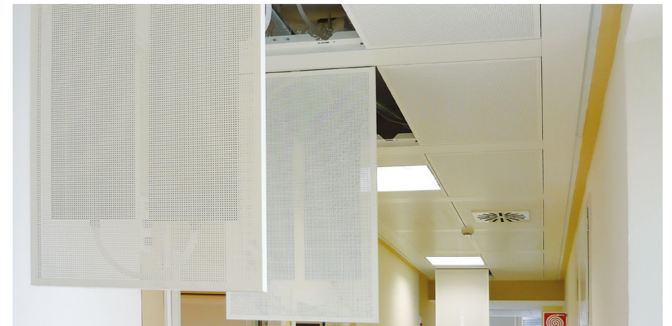
fig. 2.5 Ispezionabilità del controsoffitto radiante GK: i pannelli restano agganciati ai portanti
